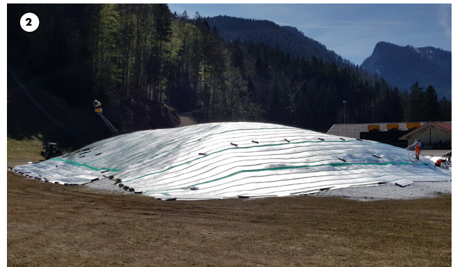
2 Abrollen der Schneedepot-Matten vom Kant-Leimholz und überlappendes Auflegen der Schneedepot-Matten - Aluseite außen (schneeabgewandt)
