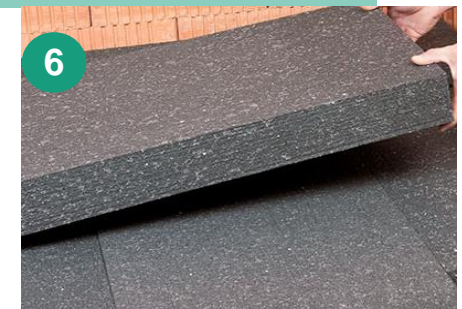
6 Direktes Recycling zu EPS-Dämmplatten
